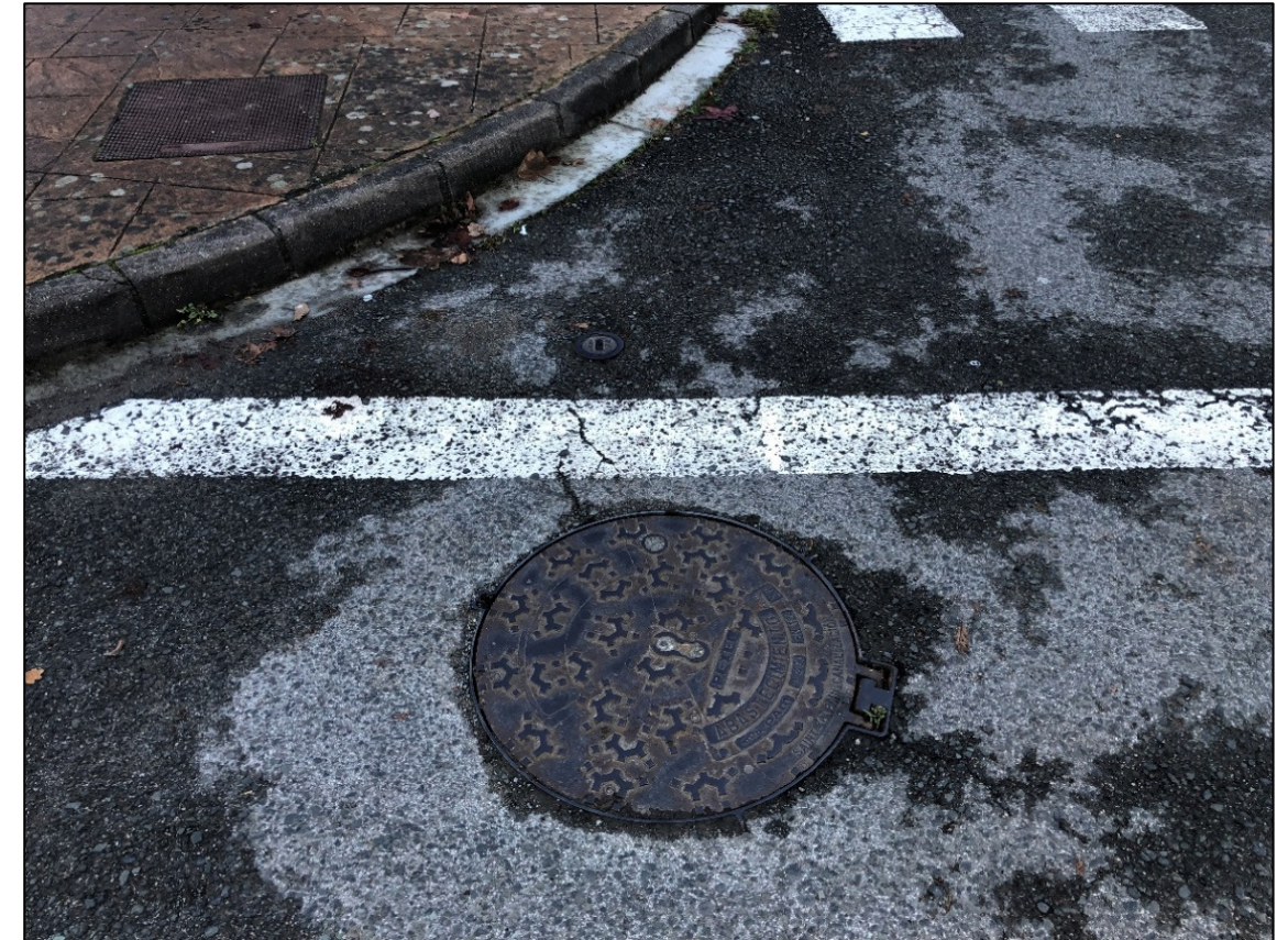
Imagen 5. Arqueta situada en la PL. Baztanberri desde donde salen las acometidas a las viviendas de la C. Braulio Iriarte.
