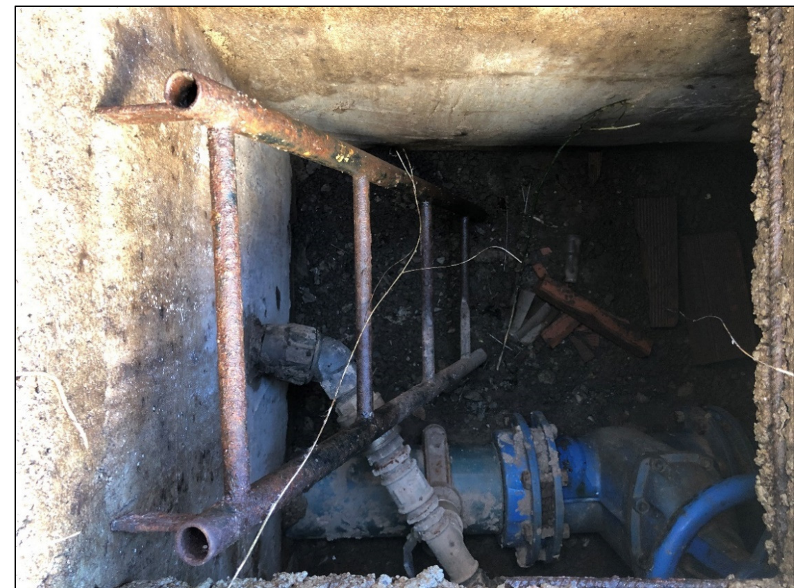
Imagen 6. Interior de la arqueta con llave de corte
