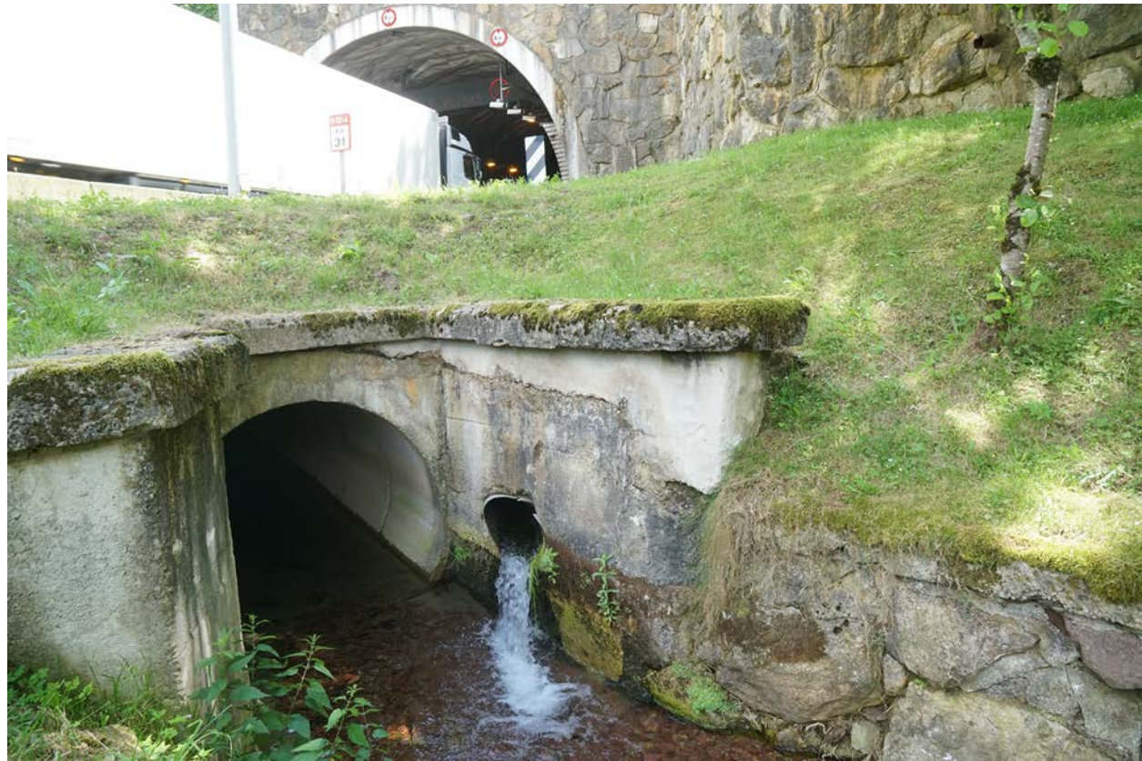
Fotografía 5.5.1.f.- Caudal drenado en la Boca norte del Túnel de Belate por el colector del hastial Oeste.
