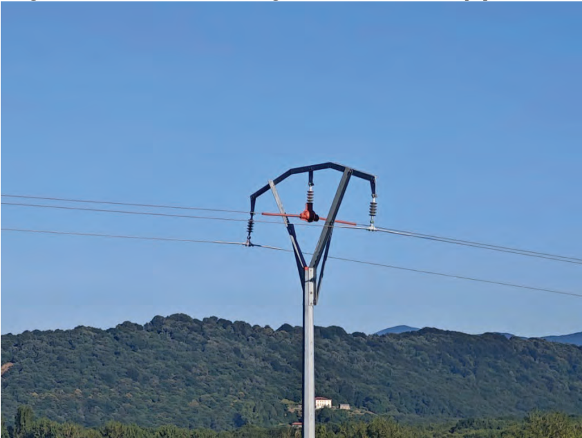
Figura 247. Tendido eléctrico corregido en Arraitz. Fuente: Equipo redactor.
