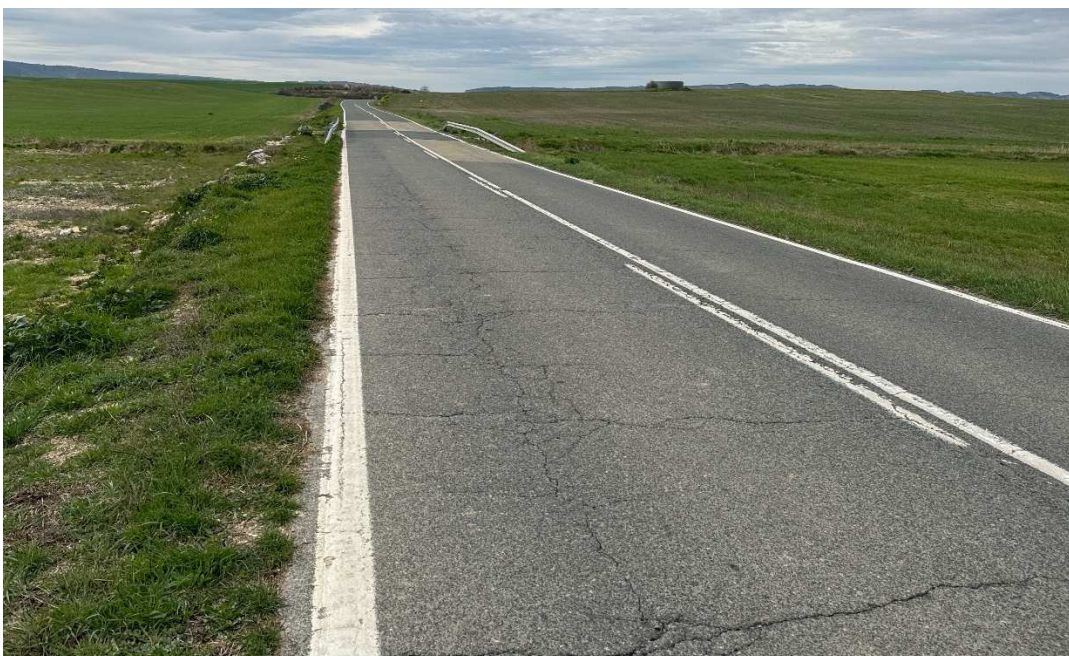
Fisuras en pavimento de calzada cuarteada
