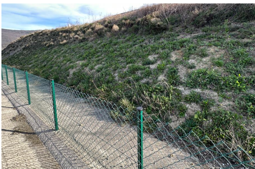
Foto donde se aprecia que inclinaciones mas laxas favorecen la revegetacion y no se registran desprendimientos
