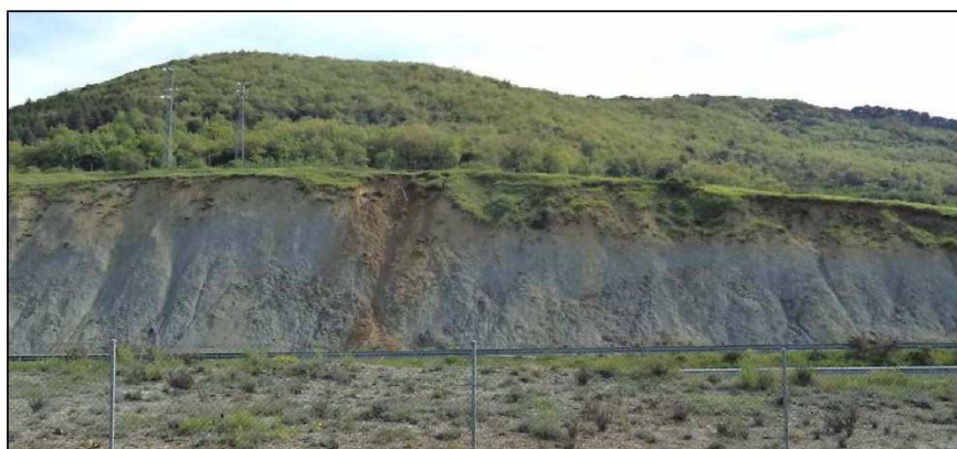
Ejemplo de acarcavamientos en taludes de marga de la autopista sita al oeste de la futura variante.
