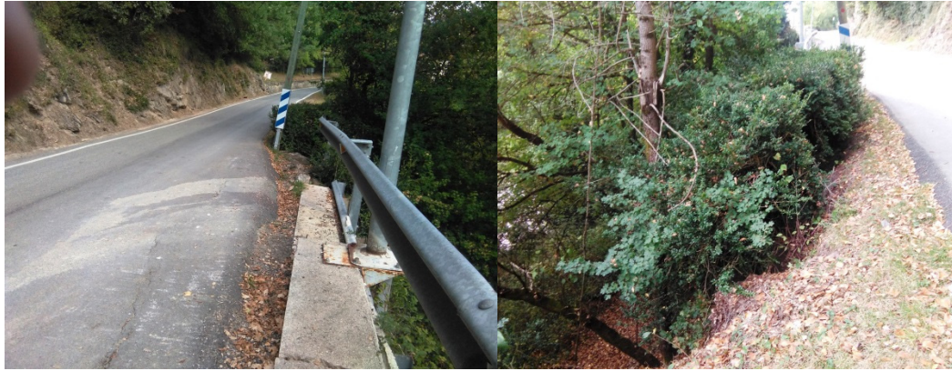
Vista de la deformación de la calzada y la erosión del relleno
