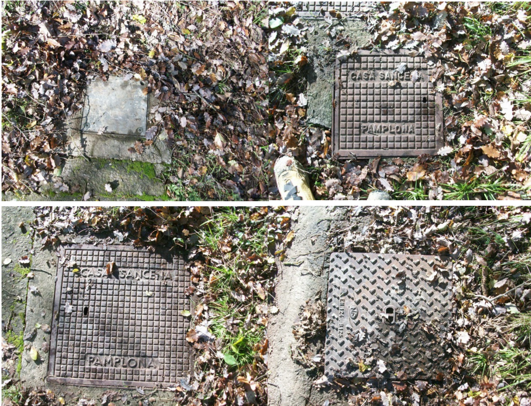
Arquetas servicios en PK 164 a 170
