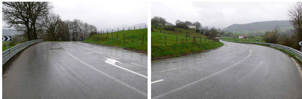
Firme en la conexión con la glorieta B 2018).
