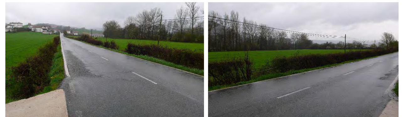
Firme en la conexión con la glorieta A (2018).
