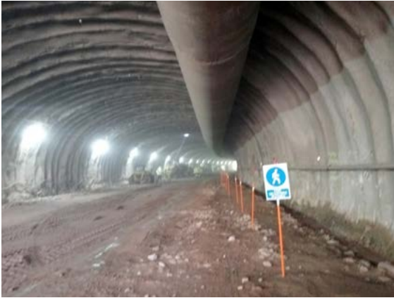
Señalización interior nuevo túnel Belate.
