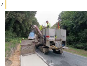
Cuneta de hormigón.
