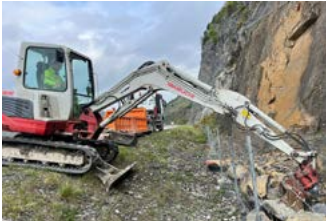
Desprendimientos - Sostenimiento talud.
