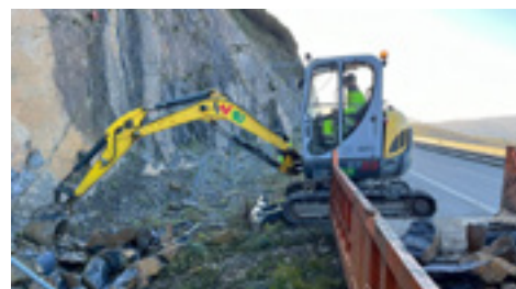
18 | Desprendimientos - sostenimiento talud.
