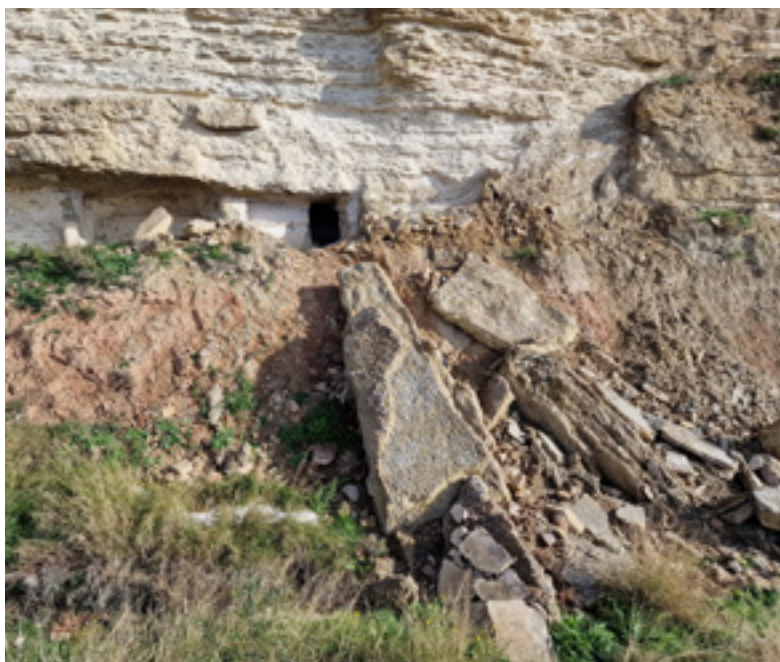
Desprendimiento de dos grandes bloques de yeso que han quedado recogidos en el interior de la berma construida al pie del talud.
