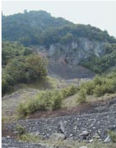
Obras de estabilización de taludes. De arriba a abajo, deslizamiento de Inza, obras de estabilización en Milagro, reperfilado de un talud en Carcastillo, talud en la carretera de acceso a Rocaforte.
