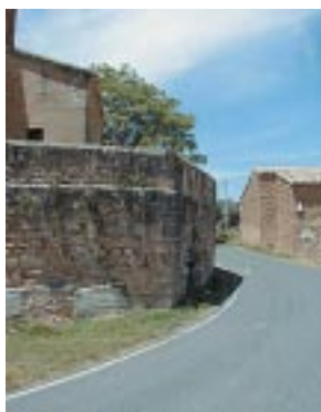
De arriba a abajo, desprendimiento en Cascante y muro de Grocin.
