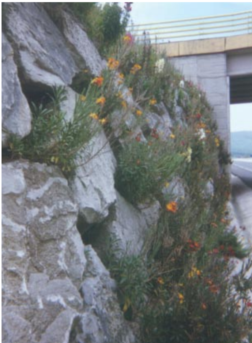
Muro construido al borde de la carretera en el que se han realizado plantaciones entre rocas.
