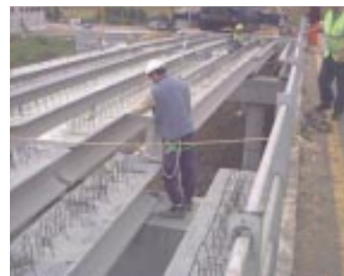
Arriba: colocación de vigas prefabricadas en la ampliación de la estructura sobre el ferrocarril de la línea Zaragoza - Altsasu/Alsua a su paso por Imarcoain.
