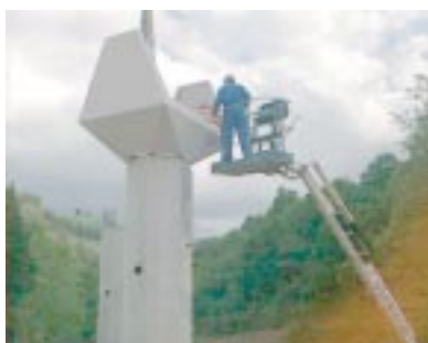
Arriba: tres momentos de la construcción del Puerto de Belate. Tramo Zozaia-Donetztebe/Santesteban. Montaje de pia y dintel prefabricados.
